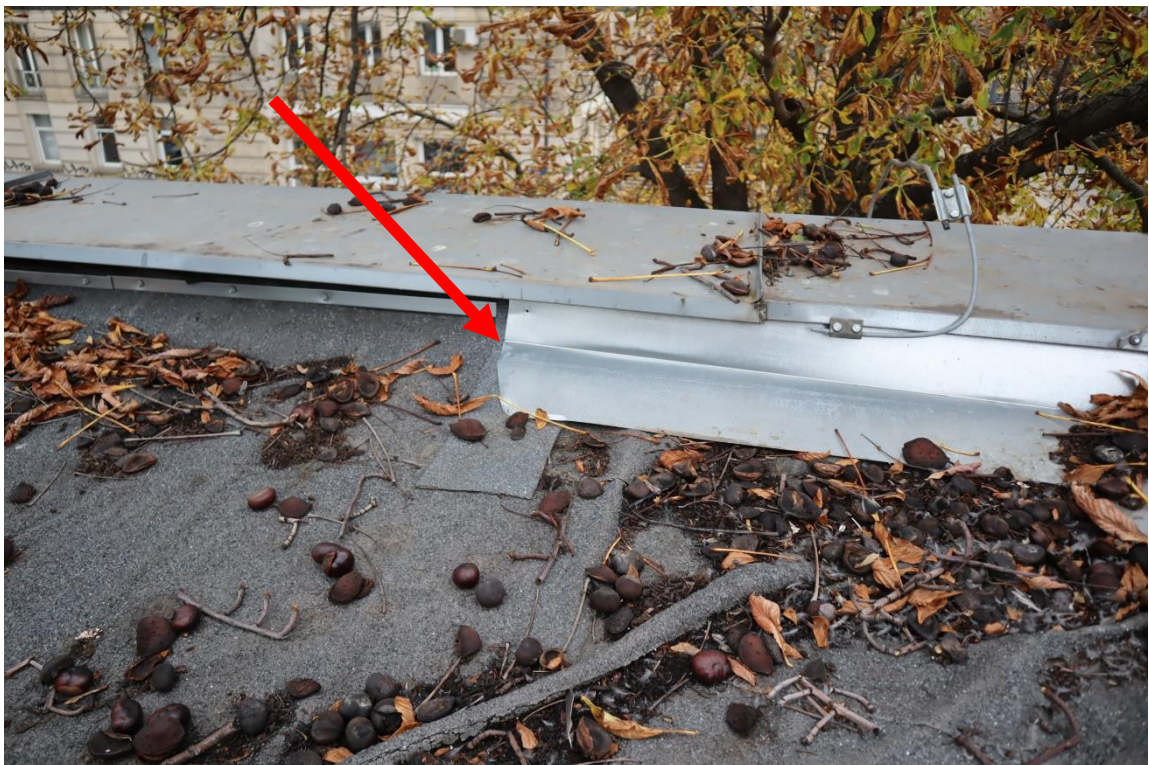
Fot. 13. Dodatkowa blacha obróbki blacharskiej zamontowana na wkręty do papy. Wadliwie wykonane pokrycie dachowe w koszu.
