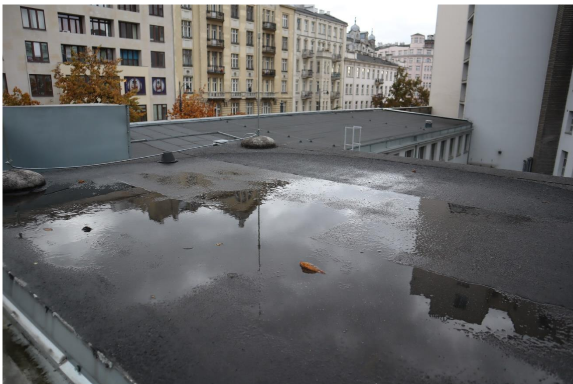
Fot. 23. Zastoiny wody na daszku nad klatką schodową
