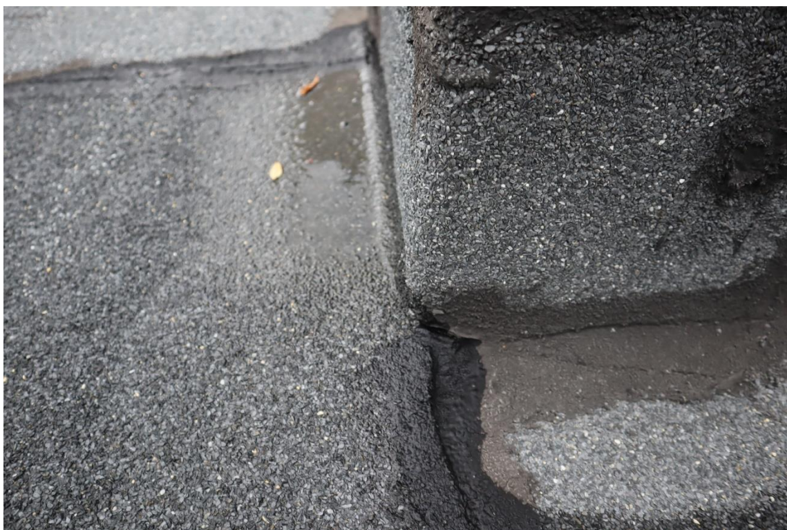
Fot. 11. Podstawa kominka wentylacyjnego – nieszczelne, dziurawe połączenie papy
