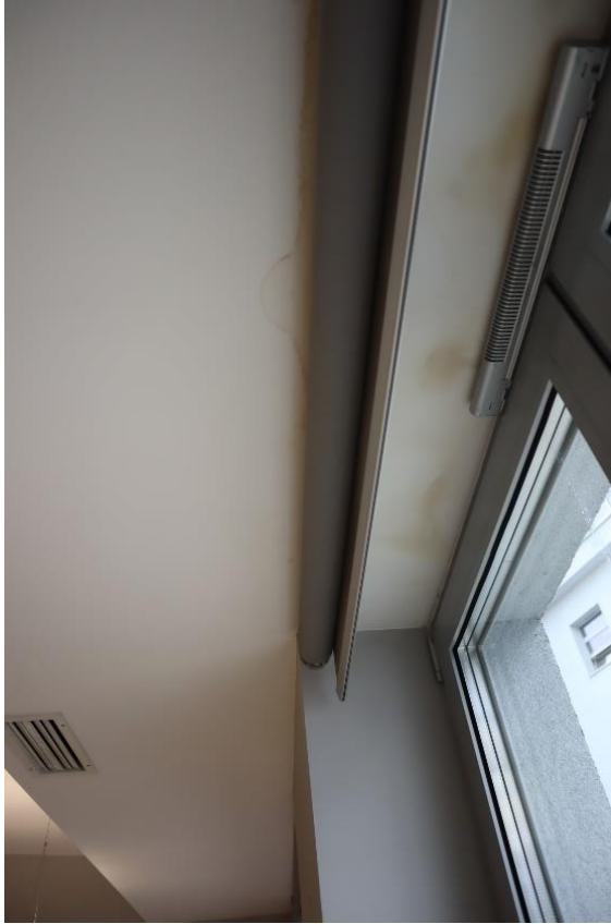
Fot. 2. Pokój na II piętrze. Ślady zacieków, kapiąca woda z nadproża okna
