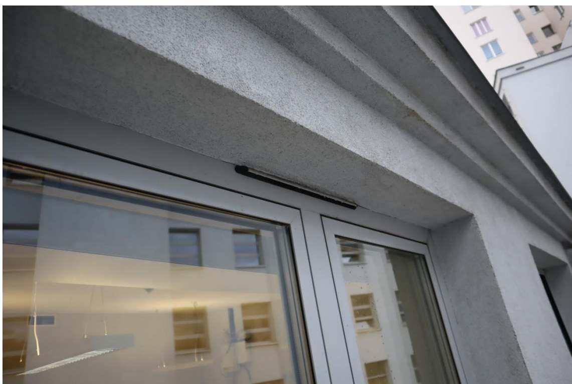
Fot. 25. Zacieki nad nadprożem okna pokoju na II piętrze; krople wody na nawietrzniku
