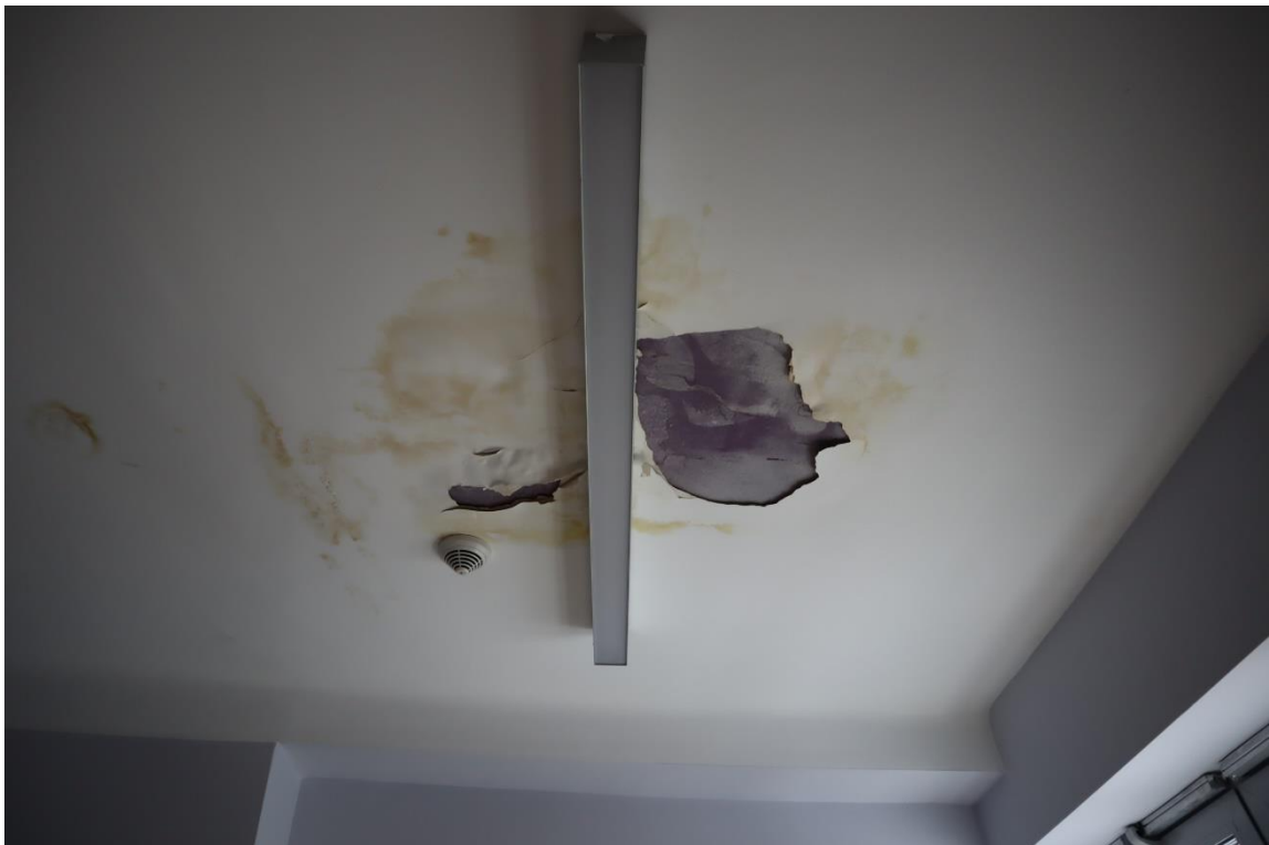
Fot. 1. Ślady po zalaniu stropu nad klatką schodową; złuszczone, odpadająca platem farba
