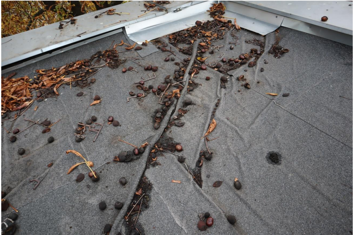
Fot. 12. Wadliwie wykonane pokrycie dachowe w koszu. Pod wpływem ciepła papa samoistnie wybrzuszyła się tworząc zaporę dla swobodnego splywu wody. Na krawędziach papa pęka co powoduje pezciki
