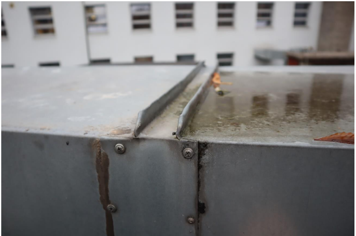
Fot. 19. Obudowa kanałów wentylacji grawitacyjnej wykonana z blachy ocynkowanej nie ma szczelności na połączeniach; woda zalega na wierzchu kształtki
