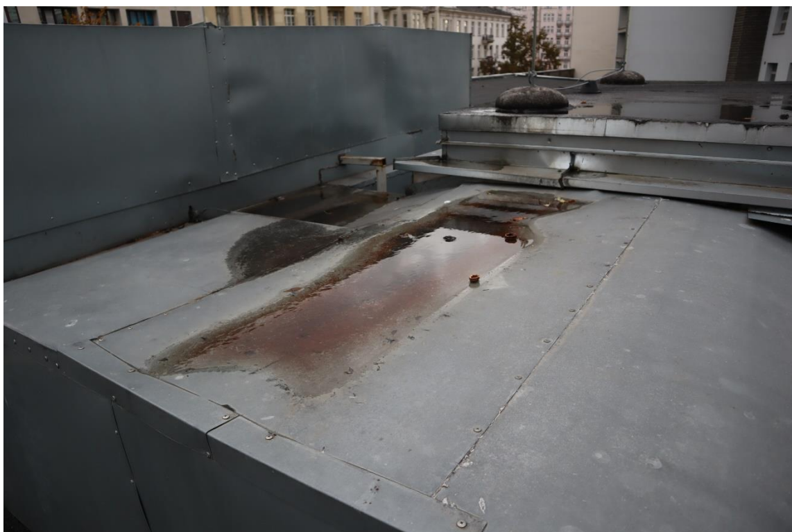
Fot.21 . Obudowa kanałów wentylacji grawitacyjnej wykonana z blachy ocynkowanej nie ma szczelności na połączeniach
