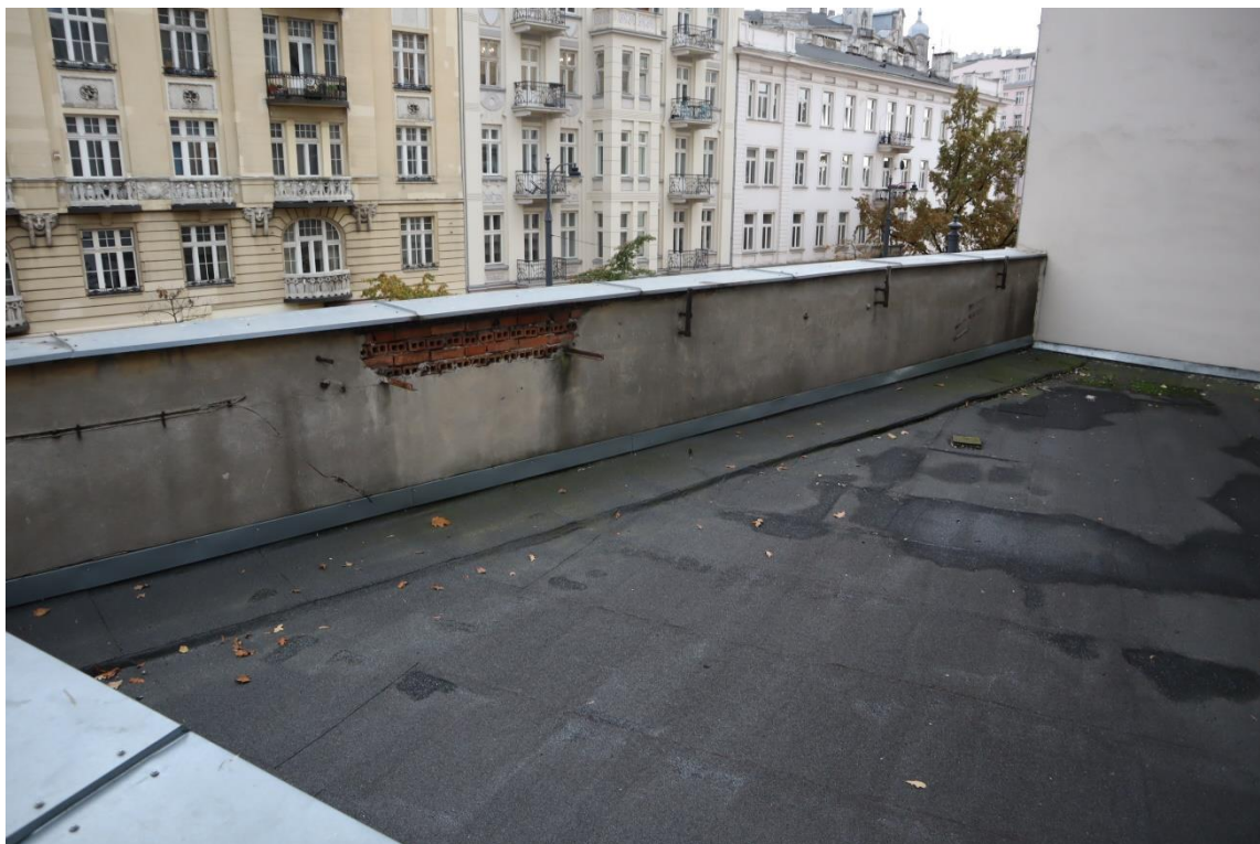
Fot. 6. Dach od strony Placu Unii Lubelskiej. Brak tynku na ścianie kolankowej
