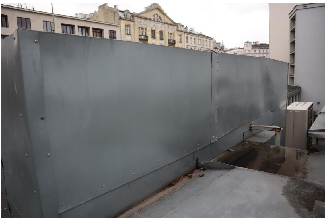
Fot. 17. Obudowa kanałów wentylacji grawitacyjnej wykonana z blachy ocynkowanej nie ma szczelności na połączeniach
