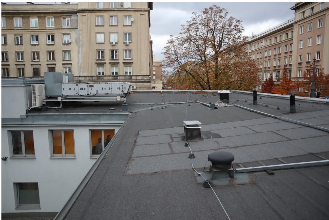
Fot. 4. Dach nad pomieszczeniami gdzie powstały przecieki
