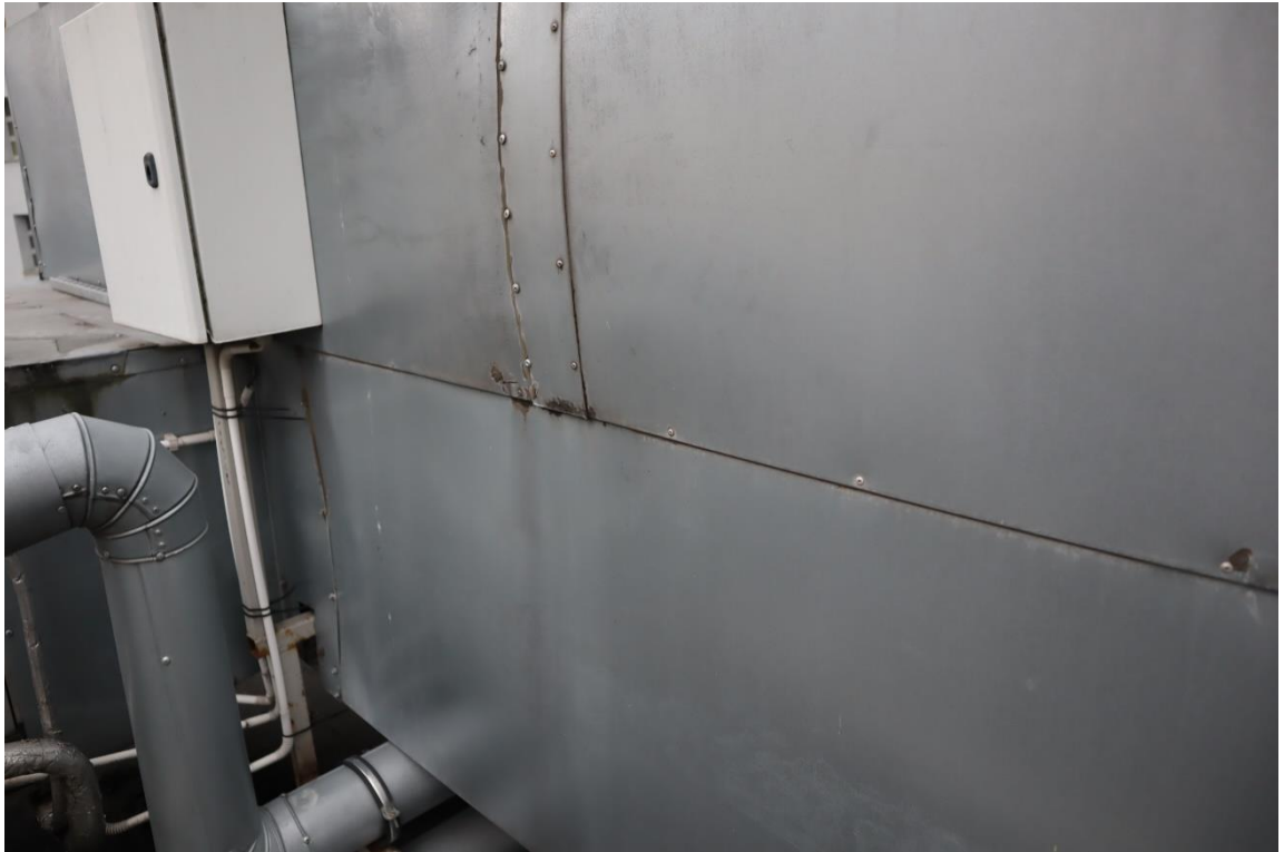
Fot. 18. Obudowa kanałów wentylacji grawitacyjnej wykonana z blachy ocynkowanej nie ma szczelności na połączeniach
