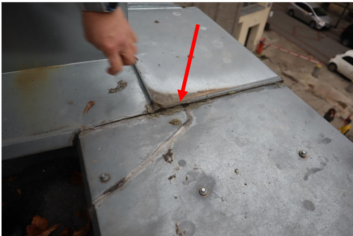
Fot. 14. Nieszczelne połączenie obróbki blacharskiej na wierzchu ścianki kolankowej
