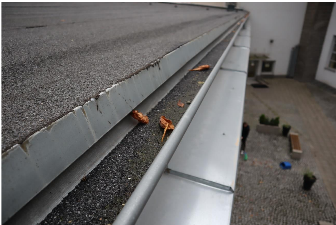
Fot. 24. Rynna dachowa wypełniona posypką z papy oraz piaskiem
