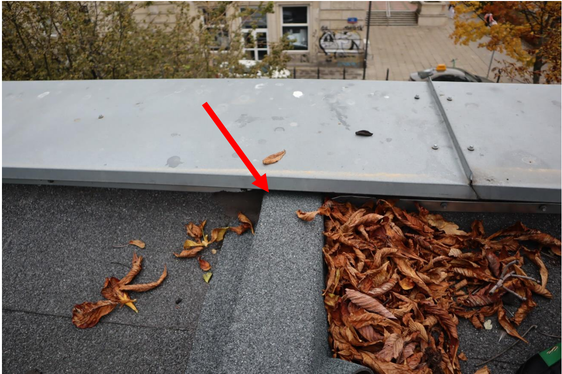
Fot. 16. Belkę konstrukcji pod wentylatory zamontowano na pokryciu dachowym prowizorycznie zabezpieczając papa
