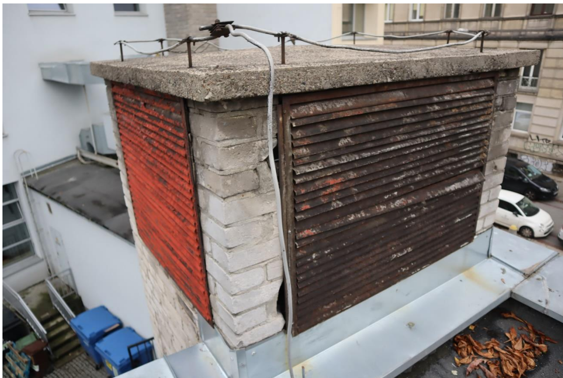
Fot. 22. Komin wentylacyjny; ubytki ścianki przy kracie
