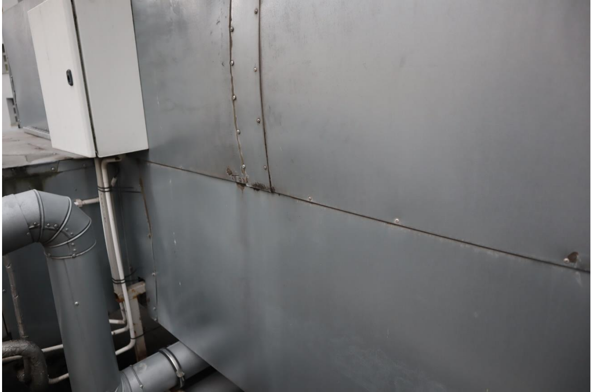
Fot. 18. Obudowa kanałów wentylacji grawitacyjnej wykonana z blachy ocynkowanej nie ma szczelności na połączeniach
