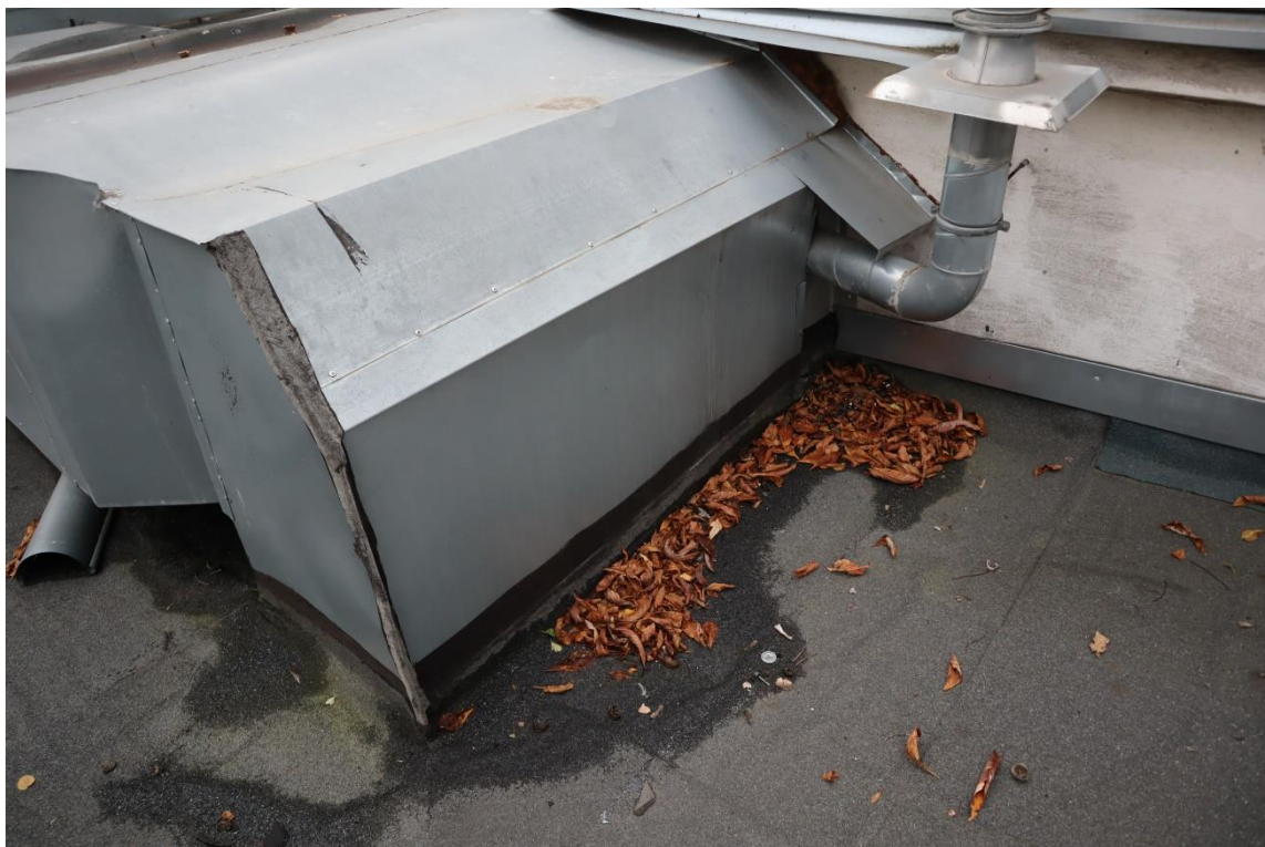
Fot. 20. Obudowa kanałów wentylacji grawitacyjnej wykonana z blachy ocynkowanej nie ma szczelności na połączeniach
