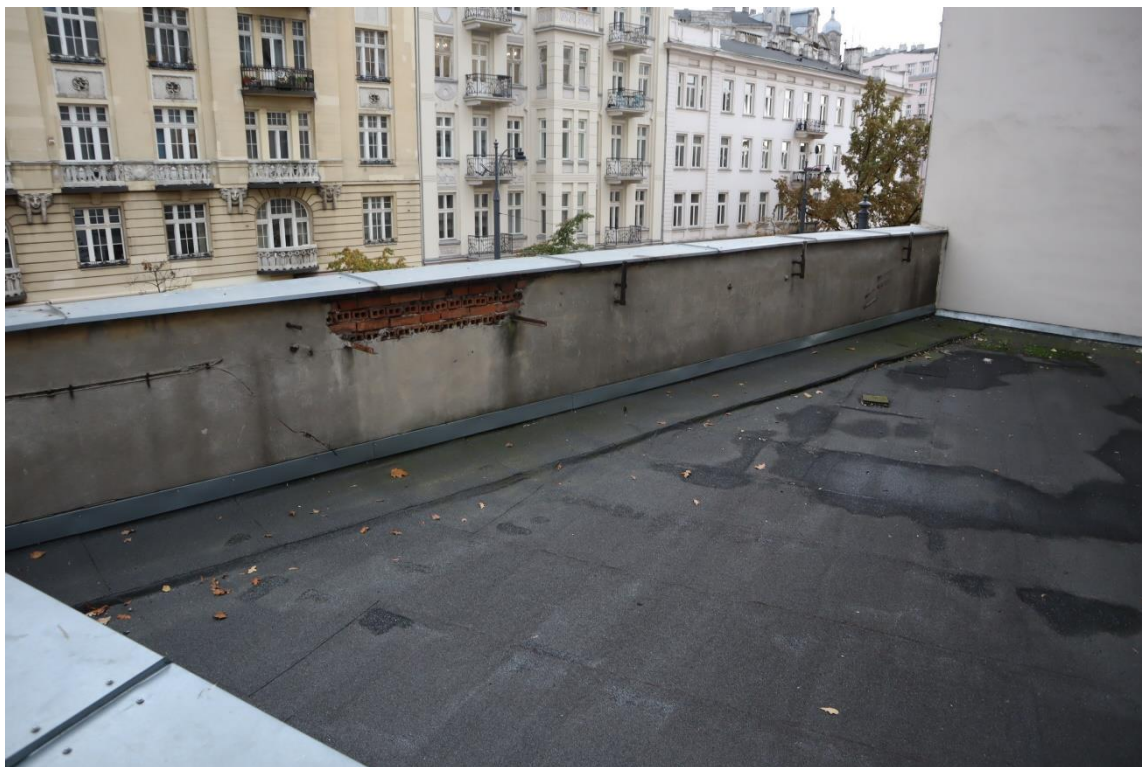
Fot. 6. Dach od strony Placu Unii Lubelskiej. Brak tynku na ścianie kolankowej
