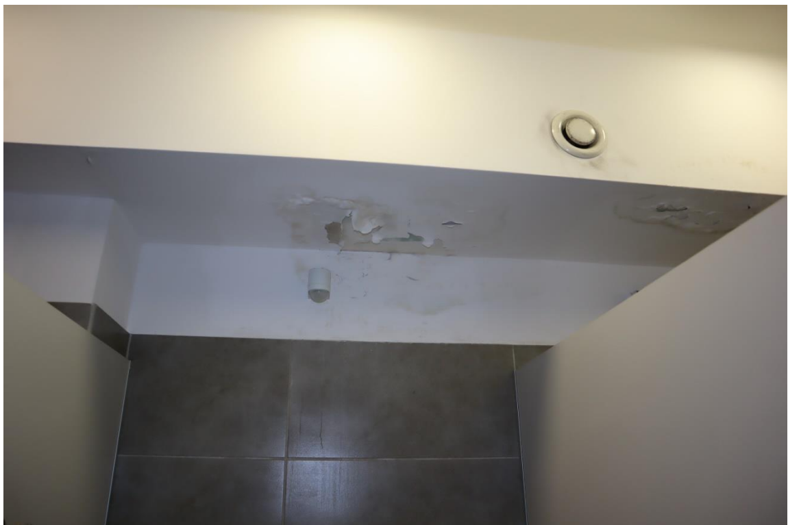
Fot. 3. Łazienka na parterze dla osób z niepełnosprawnościami. Ślady po zalaniu obudowy kanału wentylacji mechanicznej; złuszczone, odpadająca płatami farba
