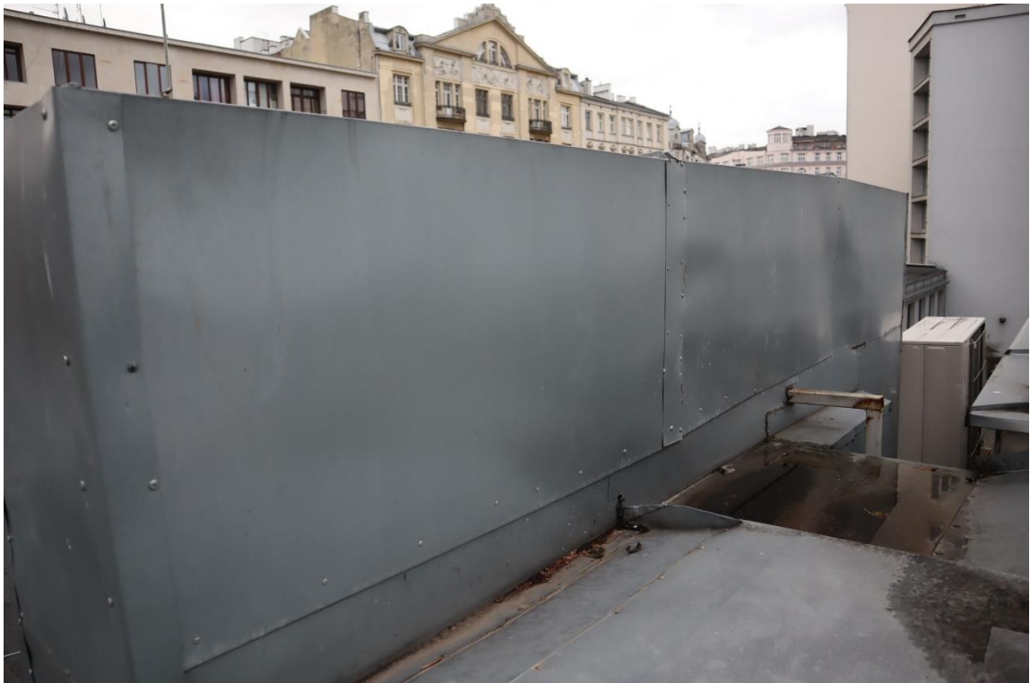
Fot. 17. Obudowa kanałów wentylacji grawitacyjnej wykonana z blachy ocynkowanej nie ma szczelności na połączeniach
