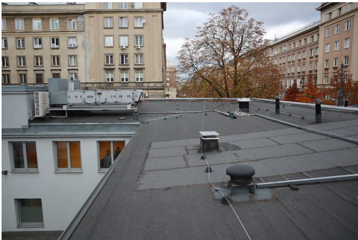
Fot. 4. Dach nad pomieszczeniami gdzie powstały przecieki
