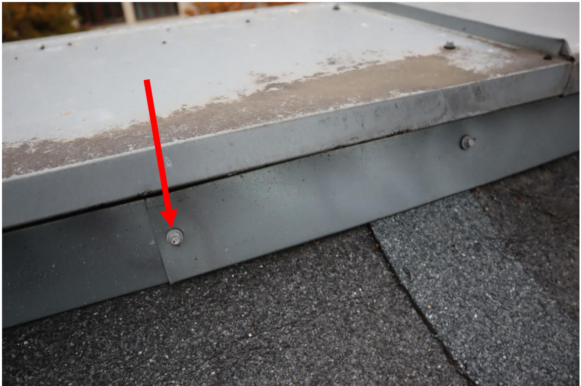
Fot.15. Paski blachy zamocowano za pomocą wkrętów, co spowodowało przedziurawienie pokrycia z papy na ściance kolankowej
